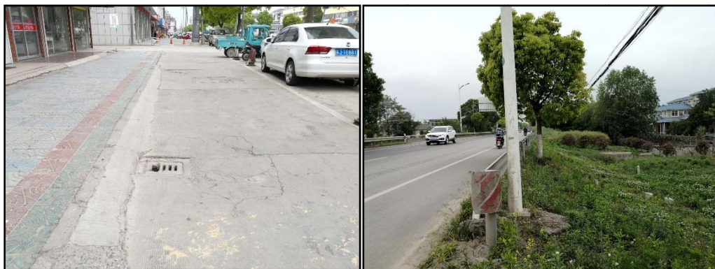
图 2.3-4 现状路基排水状况
